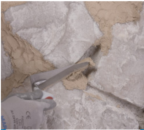
Širenje fuge u kamenom zidu
